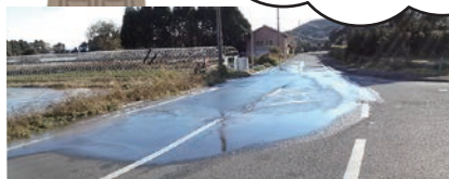
パイプライン（埋設管）の漏水状況
