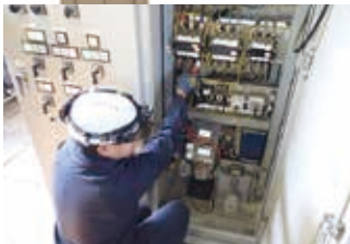
電気設備の診断状況
